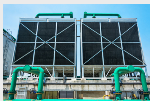
Torres de refrigeración
